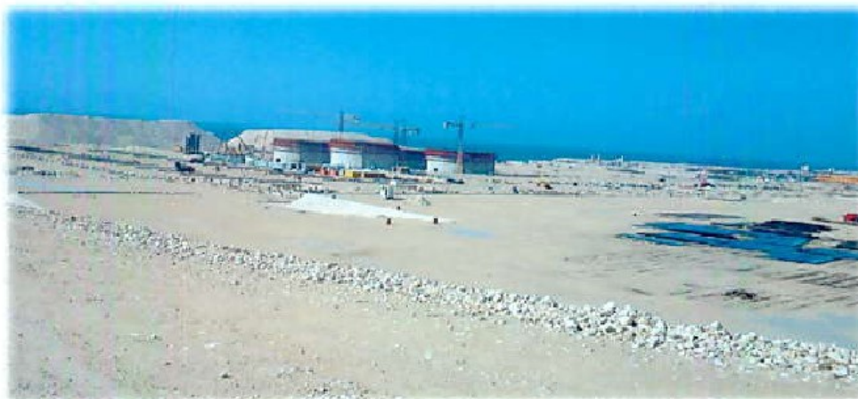
پروژه امداد مخازن فاز 14 عسلویه - EPC
