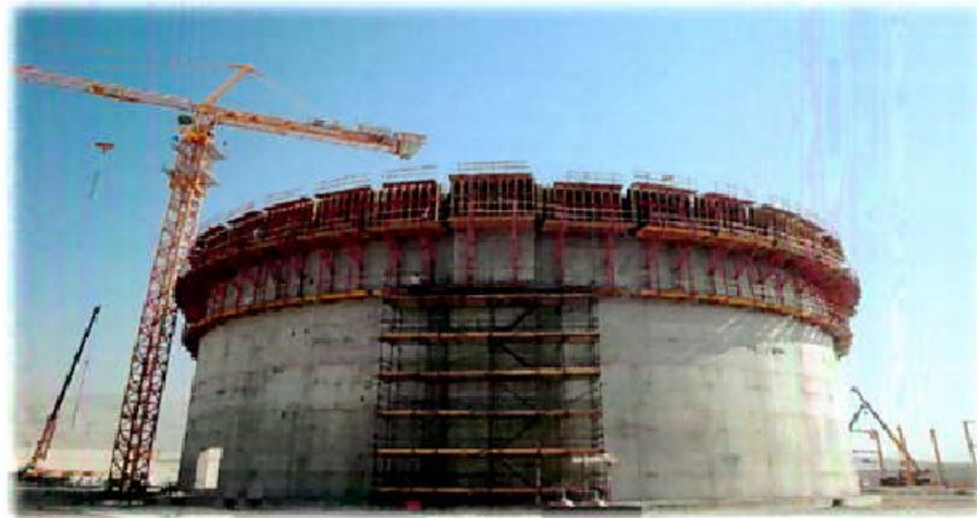
پروژه امداد مخازن فاز 19 عسلویه – EPC
